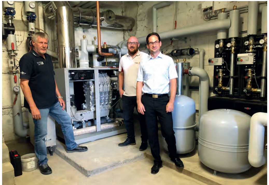
Heizungsinstallateurmeister Gerhard Bahle, TWH-Mitarbeiter Jürgen Mäck und TWH-Geschäftsführer Marc Gräßle vor der Heizungsanlage
